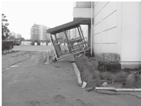
明海小学校の被害状況
