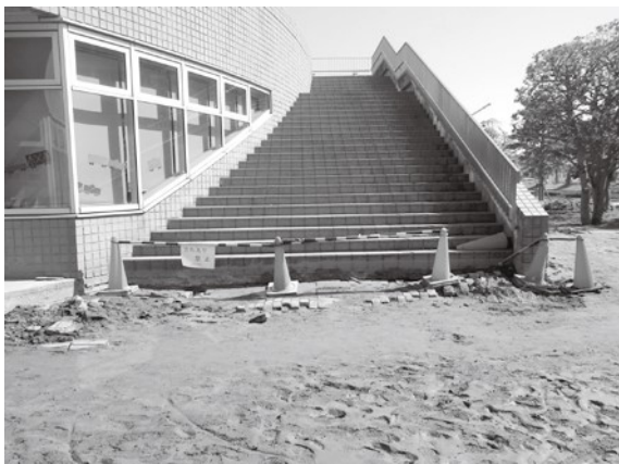
日の出公民館の液状化被害
