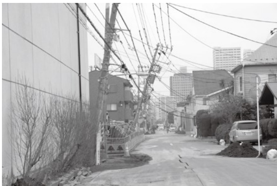
液状化被害の状況
