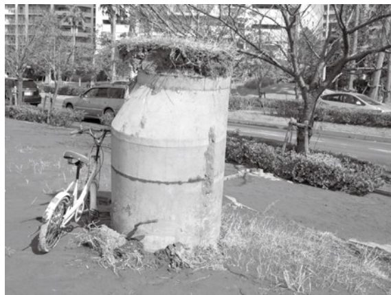
突き出たマンホール
